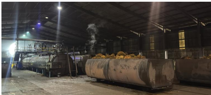
Figura 3. Área de esterilización.
