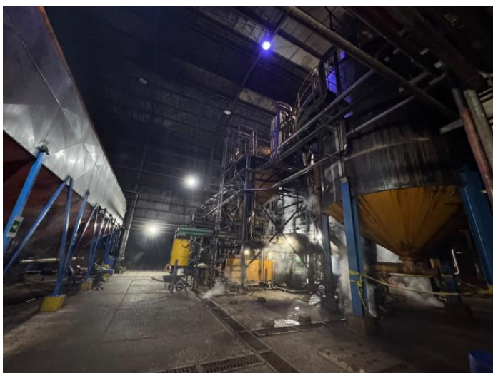
Figura 7. Área de clarificación.
