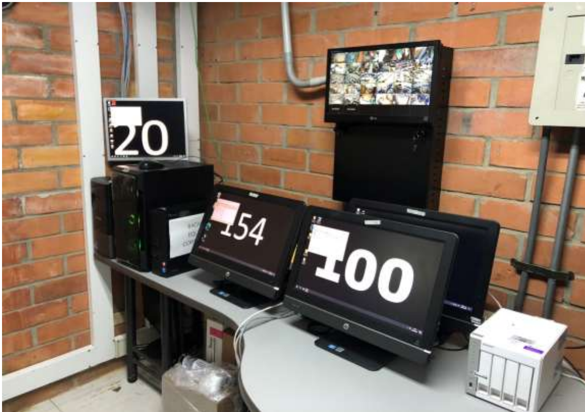
Ilustración 14. Adecuación de equipos dentro del rack
