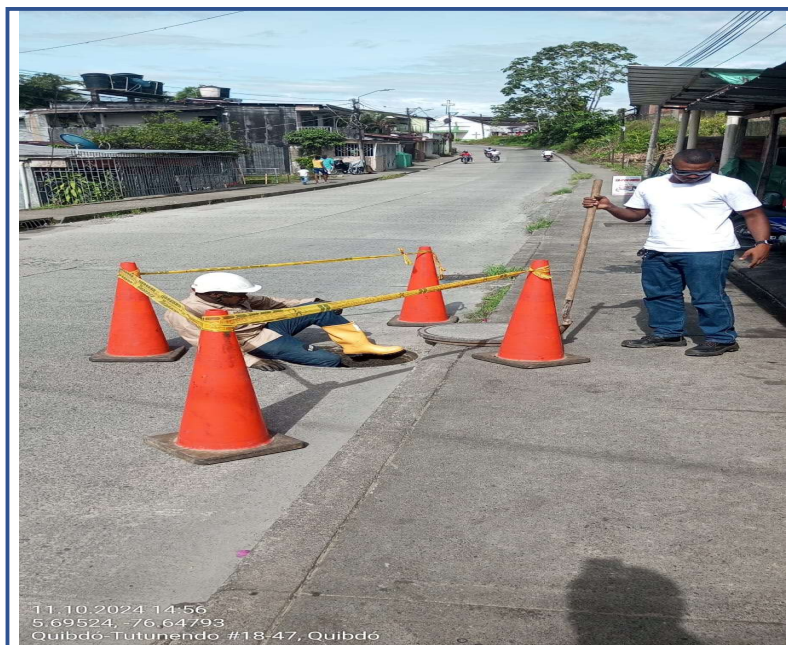
Ilustración 11 Verificación de recamaras
