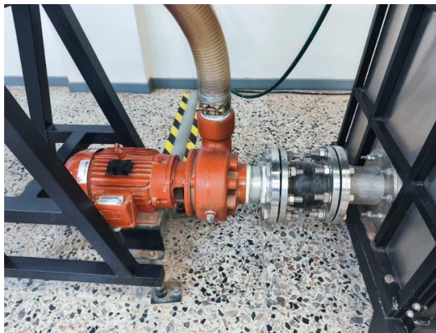
Figura 12 Bomba del canal
