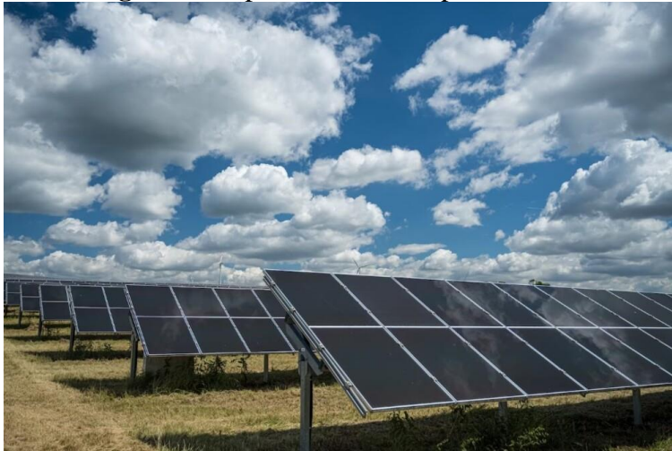
Imagen 4. - Implementación de paneles solares
